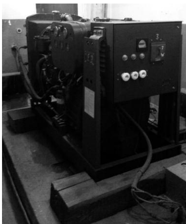
Agregat prądowórczy znajdujący się na wyposażeniu nastawni - Fot. autora
